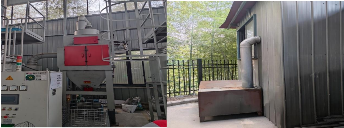
废气处理设施
